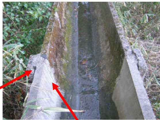
目地モルタルの割れ
