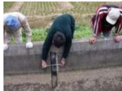
水路の目地の開き測定
