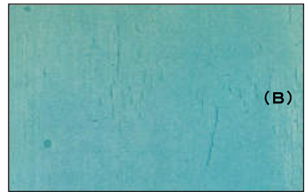
劣化標準写真（亀裂）
