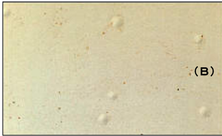
劣化標準写真（ふくれ）
