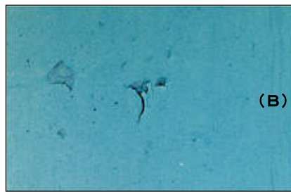
劣化標準写真（はくり）
