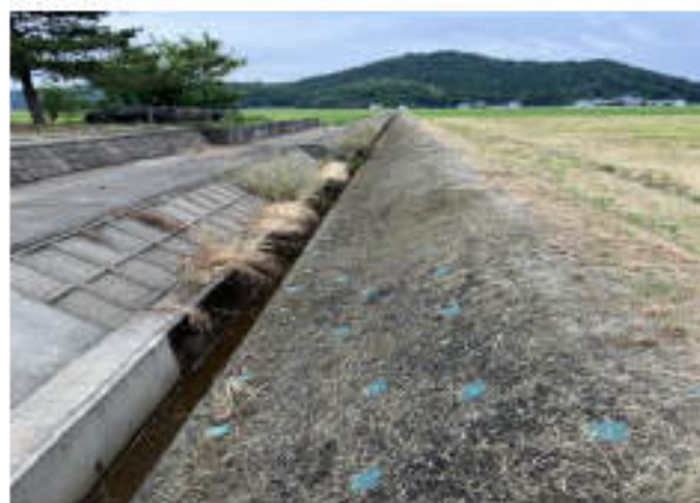
敷設後10年経過(福井県福井市)
